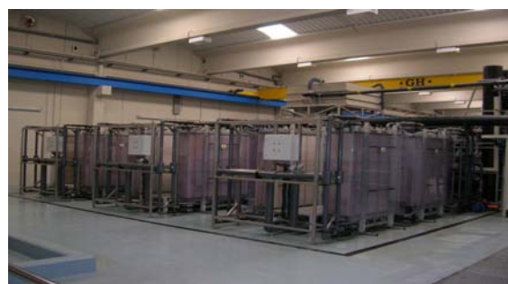
Obrázek 17: Technologie EDR firmy MEGA a.s. pro zpracování zasolených říčních vod v oblasti Depurbaix (Španělsko)
