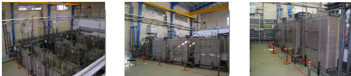
Obrázek 16: Fotografie technologie firmy MEGA a.s. pro zpracování odpadní vody petrochemického průmyslu
